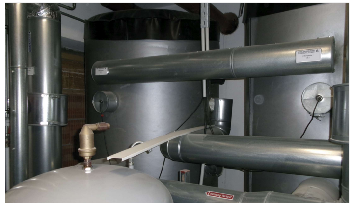
Die neue Fernwärmezentrale in der Grillparzerstraße 34 Foto: cws
