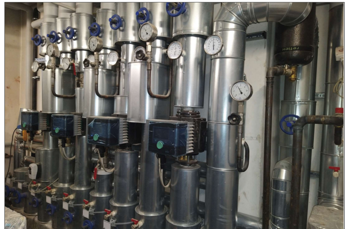
Moderne Heizzentralen wie diese in der Cherubinstraße 2 bieten eine effiziente und zuverlässige Wärmeversorgung Foto: bwv
